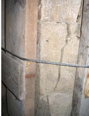
Figura 4a. Somma urgenza post-sismica: confinamento delle colonne. La riparazione statica è stata eseguita alla presenza delle opere provvisorie di cui nella foto.
