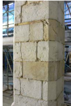
Figura 6. Le colonne erano seriamente danneggiate anche in superficie (lacune, rotture, sfogliamenti, dislocazioni).
