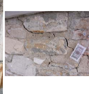
Figura 4b. Ampiezza di una delle fessure nelle colonne murarie. Le spie hanno messo in luce che il quadro fessurativo delle colonne non era stabile, ma in propagazione.
