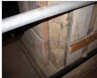
Figura 4c. Stato di fessurazione di una colonna, causato dal terremoto. La colonna non garantisce la portanza statica.
