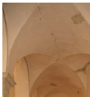
Figura 2. Navata laterale destra: lo stato di danneggiamento indotto dal sisma. La foto è stata scattata durante la somma urgenza (2002), prima di disporre i puntelli e le centine.
