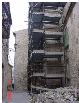
Figura 1e. Campanile: era in uno stato pericolante. In più era malamente abbordabile.
